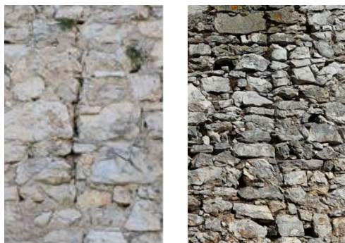
Slika 5: Pukotine u zidovima kule
