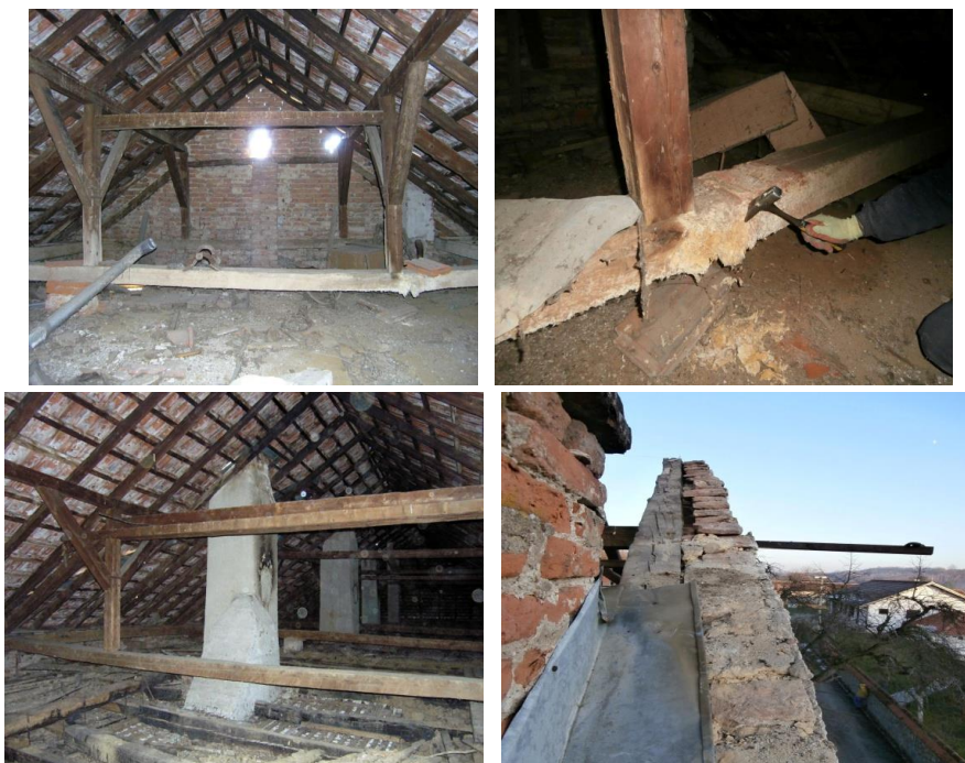
Slika 3: Fotografije oštećenja krovne konstrukcije
