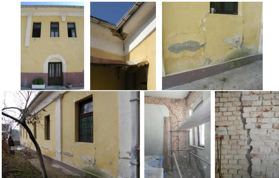
Slika 2: Fotografije oštećenja na konaku od zemljotresa
