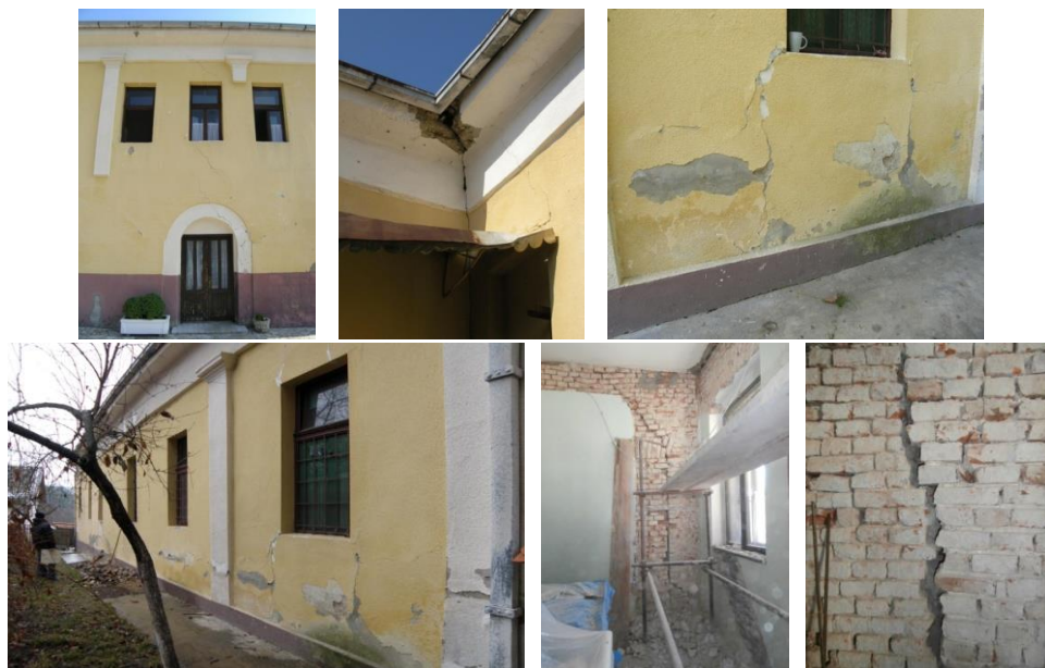
Slika 2: Fotografije oštećenja na konaku od zemljotresa
