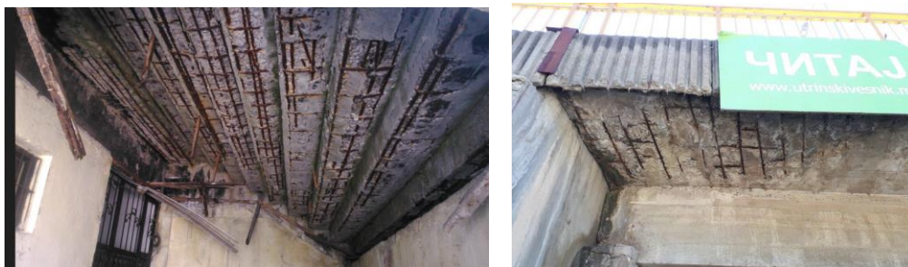
Slika 1: Efekti karbonatizacije betona na realnim konstrukcijama
